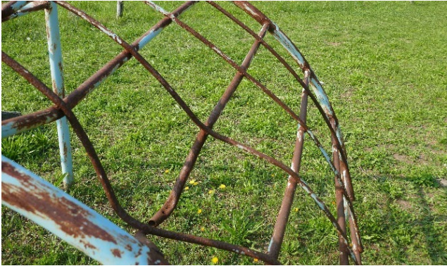
北側が大きく変形している遊具
