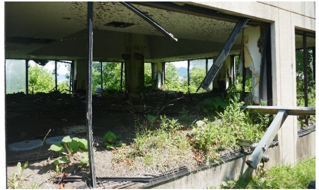
泥流によって破壊され変形した窓枠
