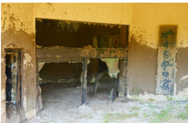
泥流で埋もれた入口
