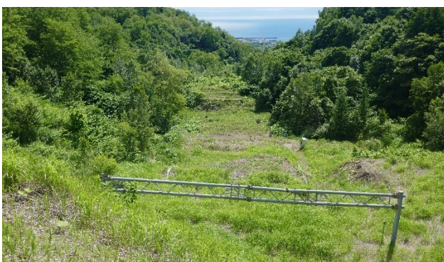
現在の階段状に破壊された旧国道
