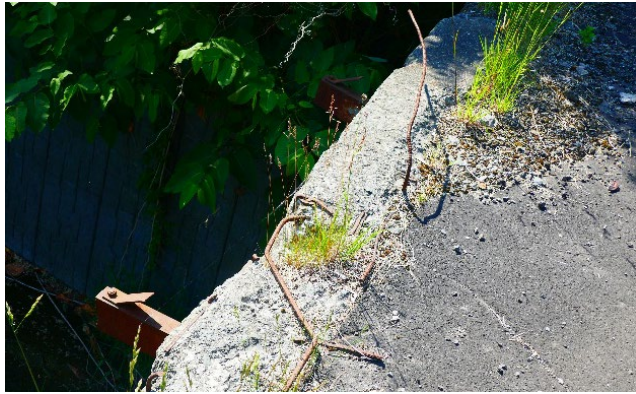
泥流によってコンクリートが削られ中の鉄筋がむき出しに
