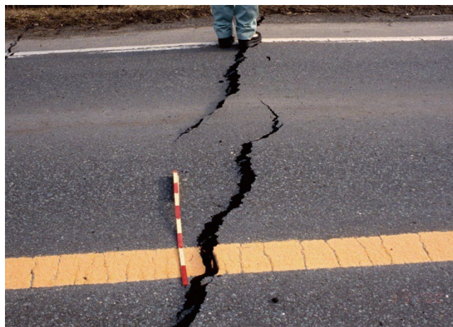
2000 年噴火前に発生した地割れ
