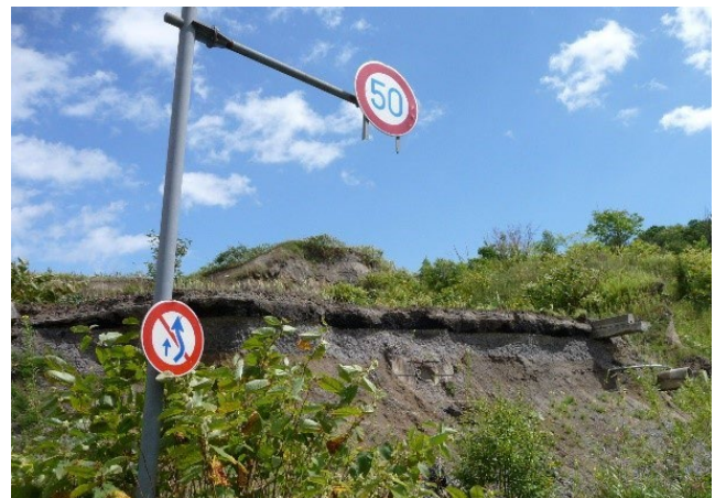
断層の下から見た階段状に破壊された旧国道
