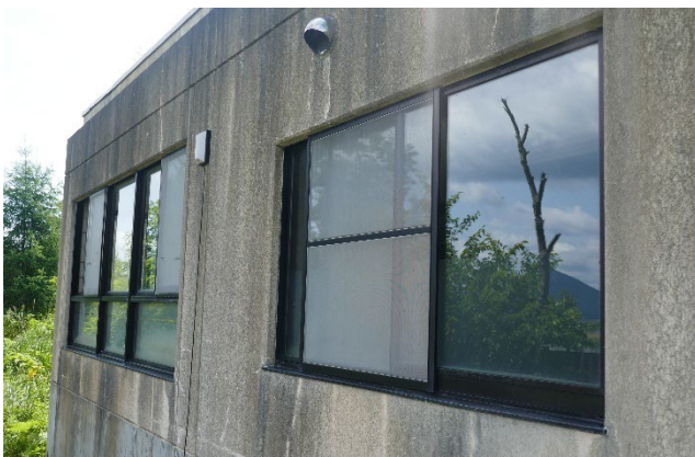
泥流が流れ込んでいない北側は窓ガラスが残っている
