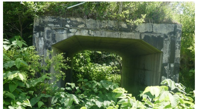
断層活動で露出した暗渠（ボックスカルバート）
